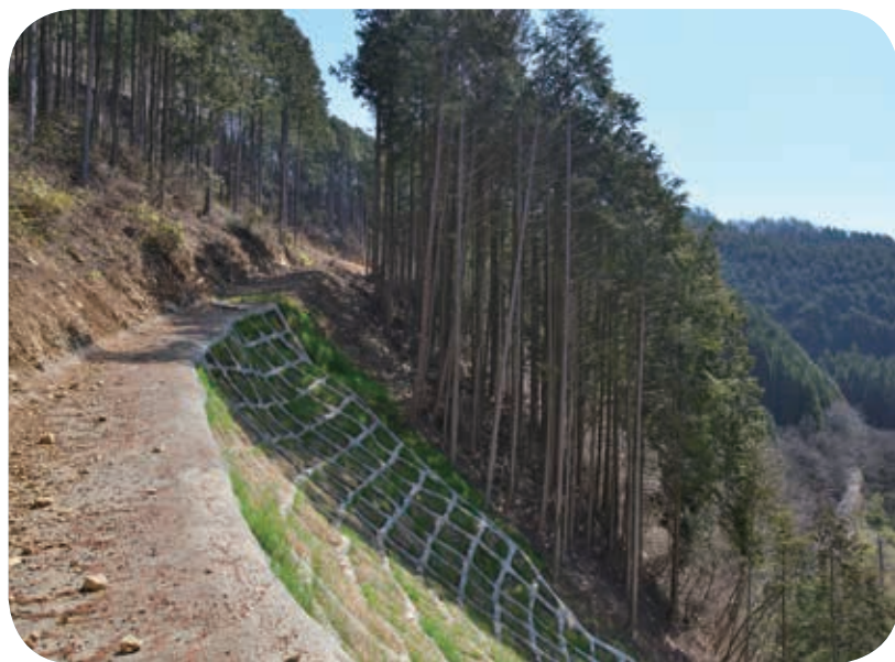
豪雨で崩落した作業道
