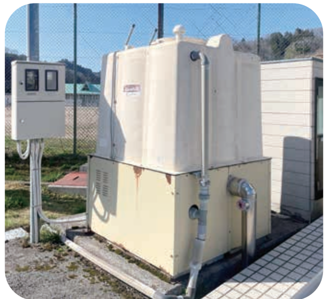
大型化予定の消防住宅受水槽
