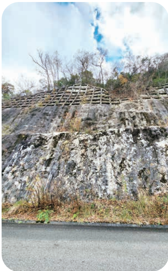
対策が必要な広域農道法面
