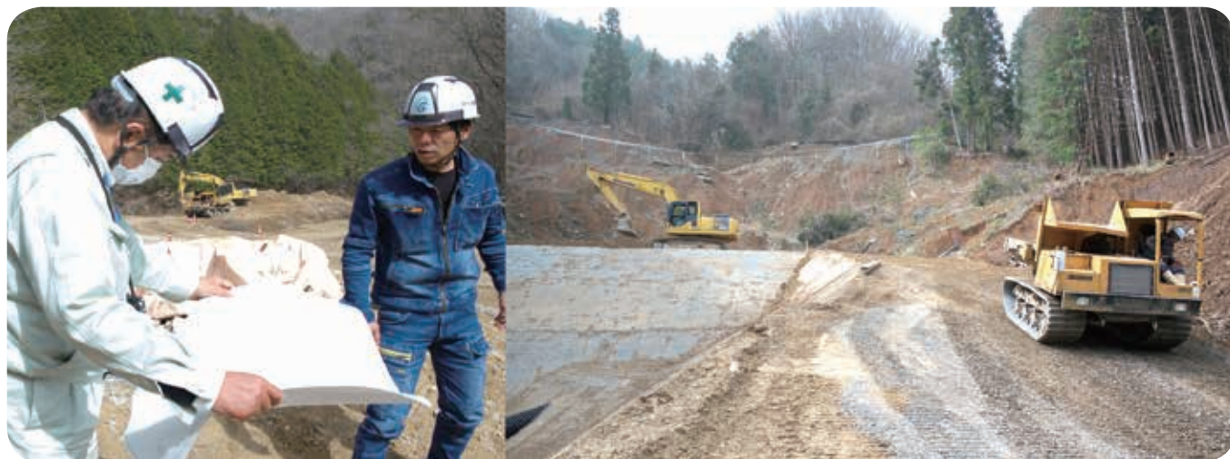
建設業者の努力により急ピッチに災害復旧が進む神石地区広域農道
