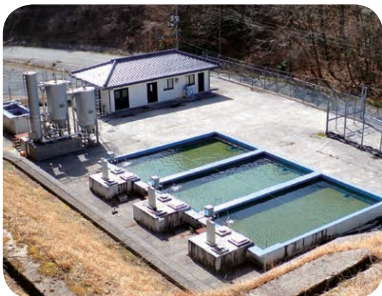
油木地区市場上水道
