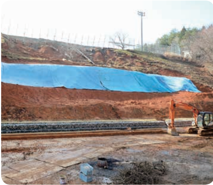
豊松山村広場 三壘側の法面崩落現場
