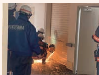
防火シャッターのカッター切断訓練
