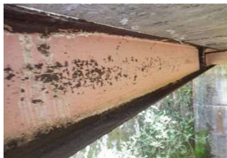
主桁の腐食・防食機能の劣化
