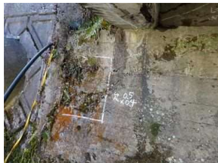
下部工のひび割れ
